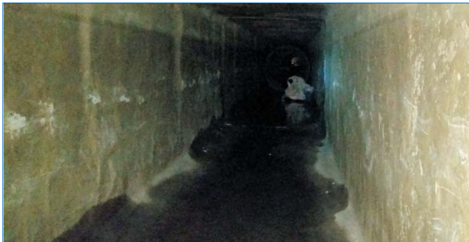
■ Рис. 1. Подземный водовод, подлежащий восстановлению
